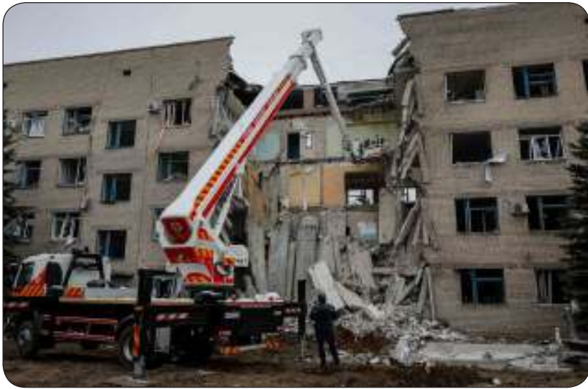
■ مستشفى سيليدوف الذي طالقه القصف
