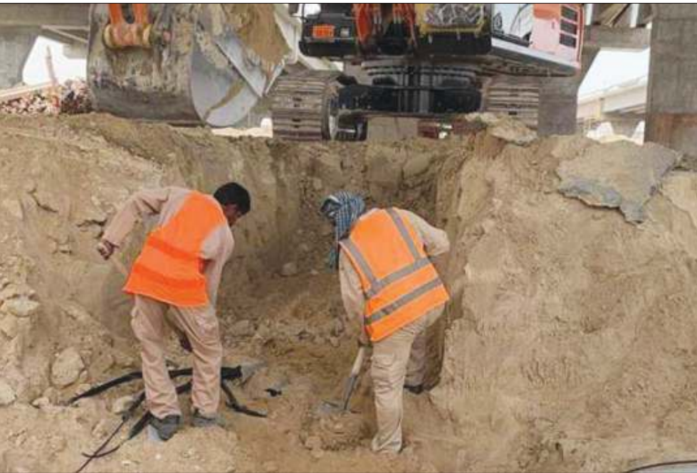
انقطاع الإنترنت حدث بسبب عطل الكوابل الناتج عن أعمال بعض الطرق في البلاد
