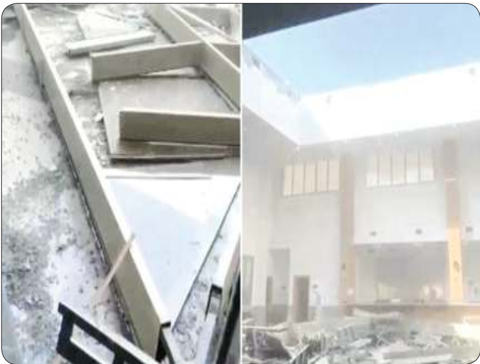
■ جانب من الانهيار الذي تعرض له سقف مبنى إدارة مرور الجهراء
