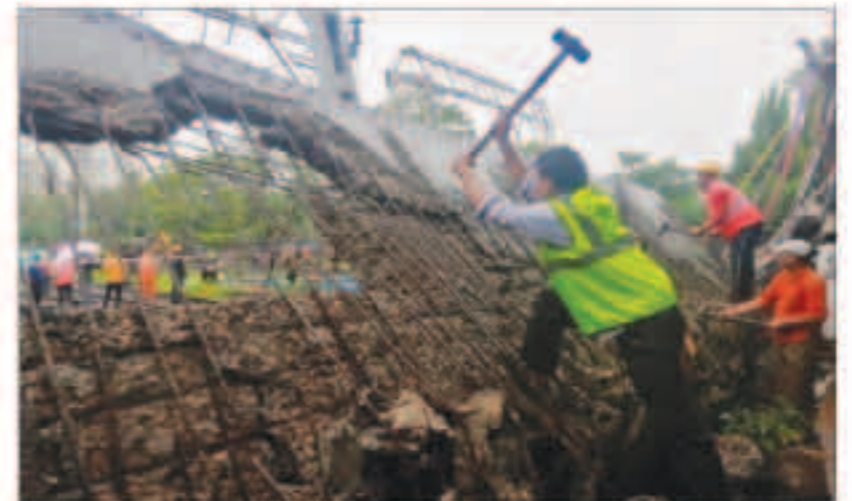
عمال الإنقاذ والسكك الحديدية يعملون في موقع انهيار جسر بعد أمطار غزيرة
