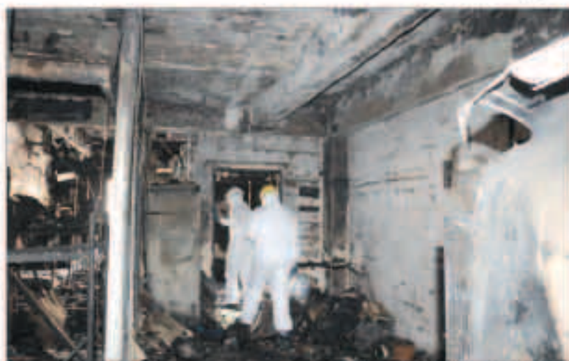
فحص العمارة التي تعرضت للحريق
