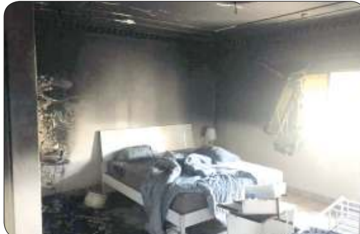
جانب من الحريق
