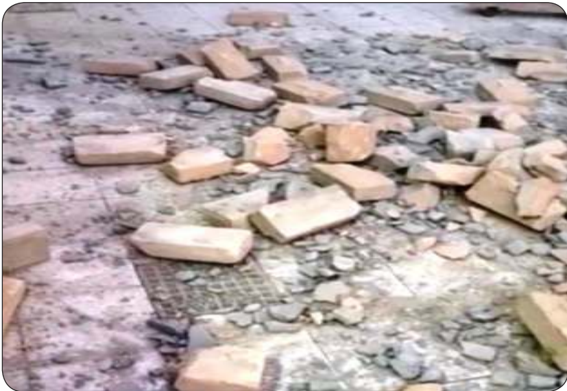
سقوط واجهة أحد المنازل بفعل الزلزال
