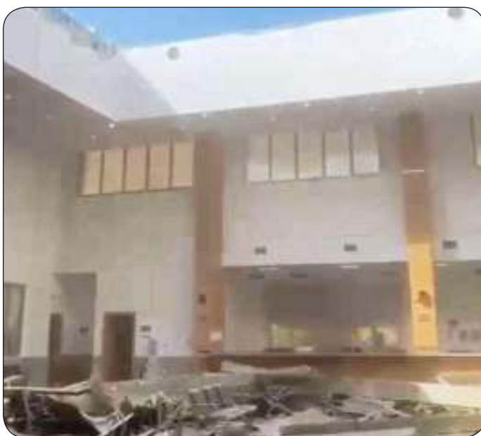
قسم رخص المركبات في مرور الجهراء بعد سقوط سقفه
