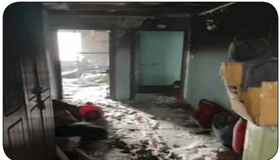
■ جانب من الحريق
