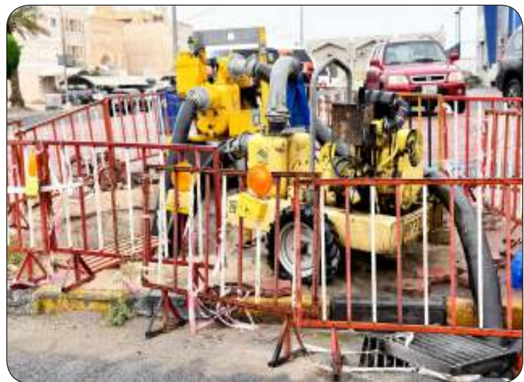
المضخات الخاصة لتصريف المياه في الطرق
