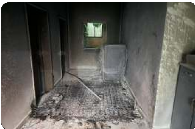
جانب من الحريق
