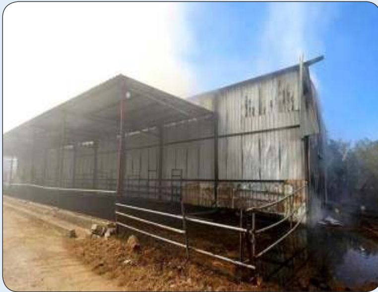
■ جانب من الحريق
