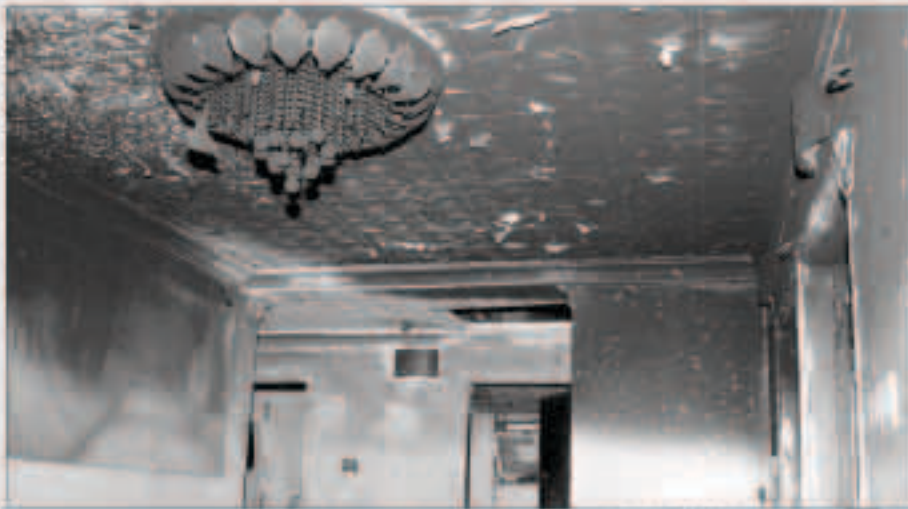
إحدى الشقق وقد أتى عليها الحريق
