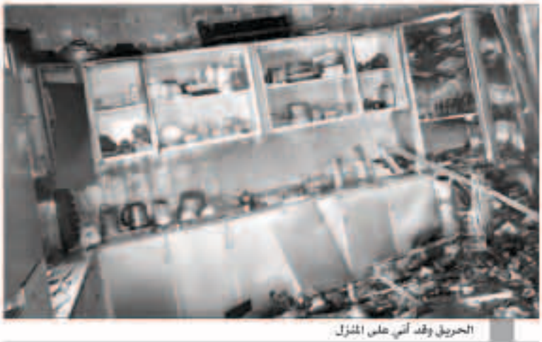
الحريق وقد أتى على المنزل
