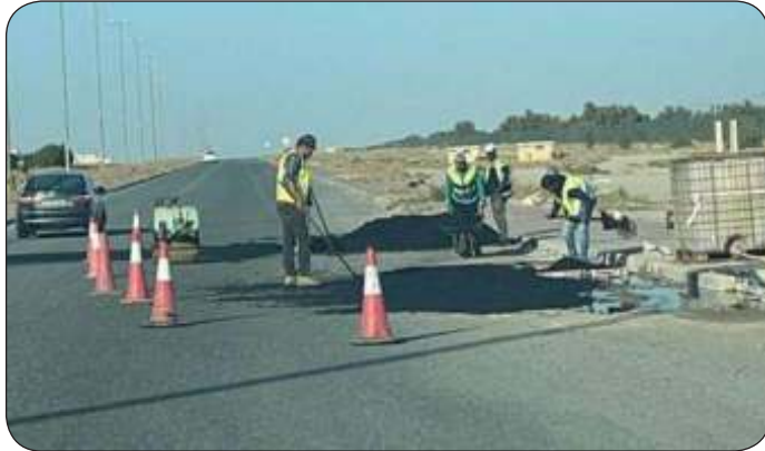
■ بدء إصلاح الحفر في طرق المناطق الجنوبية
