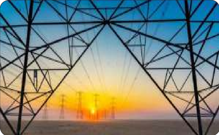
مؤشر الأحمال الكهربائية يقترب من ذروة الاستخدام
