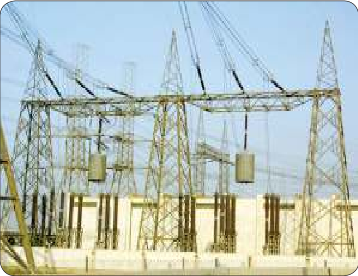
الشبكة الكهربائية على موعد مع مشاريع عملاقة لتجاوز الأزمة
