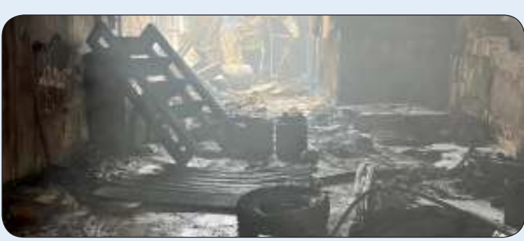
جانب من الحريق
