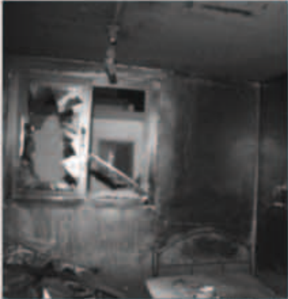
جانب من الحريق
