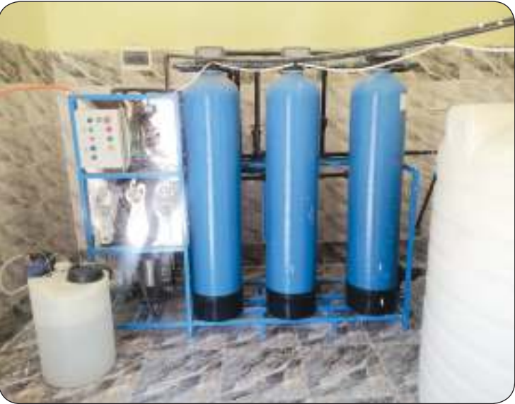
جانب من محطة تحلية مياه الشرب من الداخل
